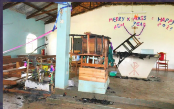
Церковь в Кении после пожара
