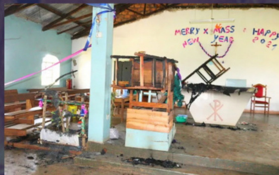
Церковь в Кении после пожара
