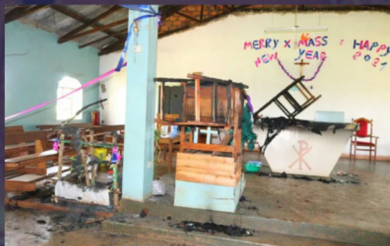
Церковь в Кении после пожара
